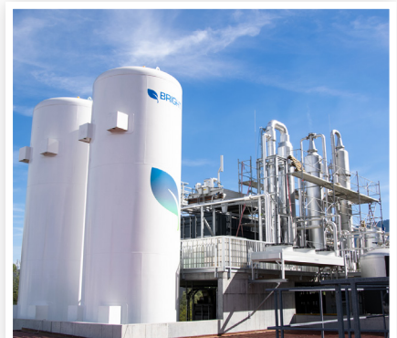
Jährlich werden in der Anlage 3.700 Tonnen CO 2 aus den Rauchgasen abgeschieden.
